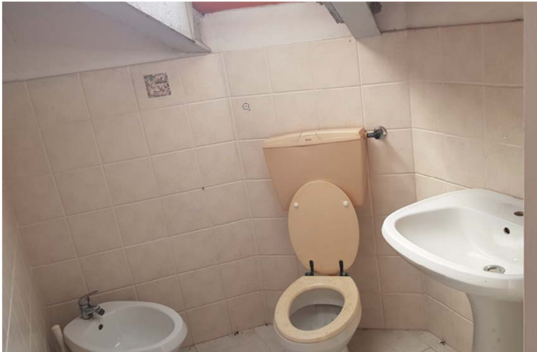
40. P2 – bagno abusivo
